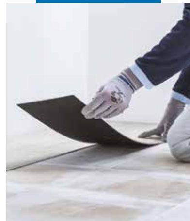
Układanie samoprzylepnych paneli LVT na posadzce ceramicznej wyrównanej z użyciem Planiprep 4 LVT
